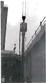
杭規格：H400×400 (L=16m) 発注：JR東日本 工事名：品川駅ハツ山アンダーパス新設
