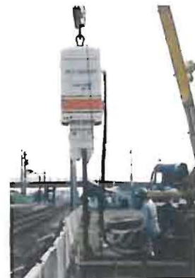
矢板規格：SP-II型 (L=6m) 発注：JR九州 工事名：羽犬塚駅構内自由路新設他
