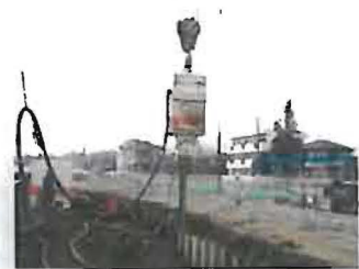
矢板規格：SP-III型 (L=10.5m) 発注：国土交通省 工事名：日野共同溝工事
