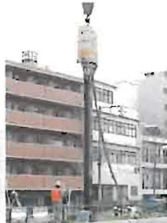
杭規格：H300×300 (L=28.5m) 発注：広島市 工事名：明治橋仮歩道橋設置工事
