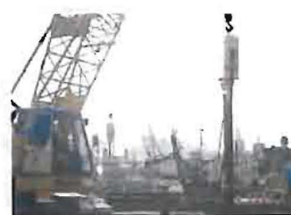
矢板規格：SP-III型 (L=16m) 発注：JR東日本 工事名：柳原橋内新設工事
